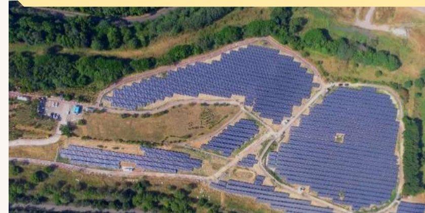
Taichung WenShan Landfill 6.2 MW
